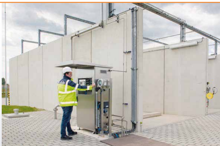
Energiepark Mainz: Nach einer rund zweijährigen Forschungsphase befindet sich die Anlage seit 2018 im Betrieb.
